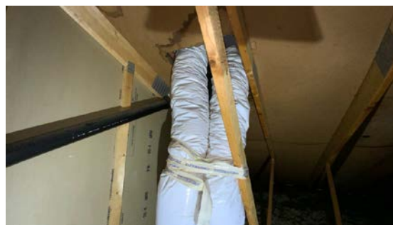
Kontroll rundt rørgjennomføringer. Det er påvist fuktskjolder i undertak/takkonstruksjon.
