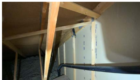
Brannkasse 1 meter ut fra vegg bør opparbeides for tilfredsstillende sikring.
