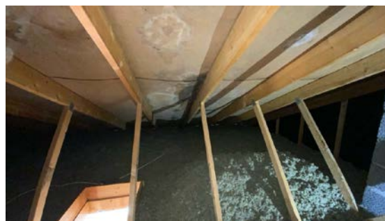
Det er påvist fuktskjolder i undertak/takkonstruksjon.
