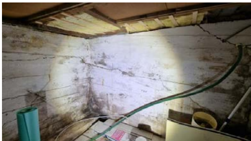
Det er sprekk i grunnmur.
