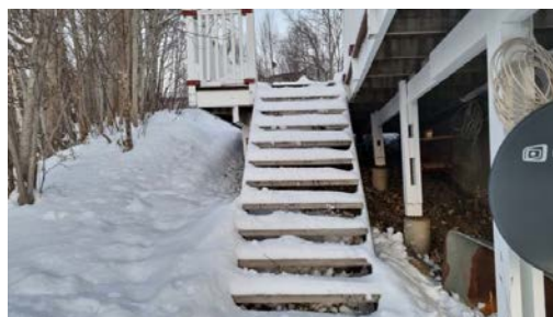
Trapp mangler rekkverk.
