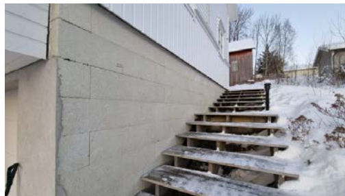
Grunnmur er ikke utvendig pusset og det er fritt eksponert isopor.
