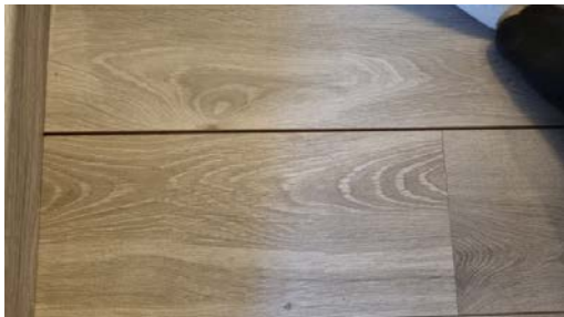
Det er sprekk i laminat.
