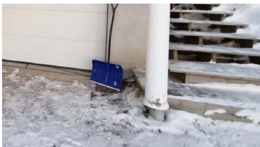
Det er noe skjevheter i fundament.
