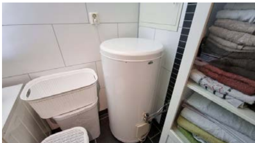
Varmtvannsbereider i utleieleilighet er tilkoblet via stikk.
