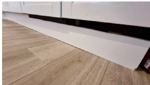
Ufagmessig utførelse av sokkelist.
