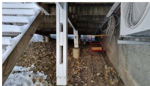
Det er skjevheter i søyler.
