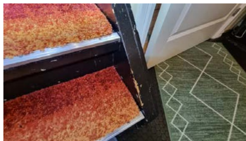
Sår/hakk i trappevange på trapp mellom 1. etasje og 2. etasje.
