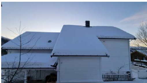
Det er ikke montert snøfangere.
