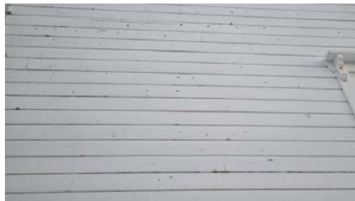
Kledning er noe værslitt (fasade mot vest).
