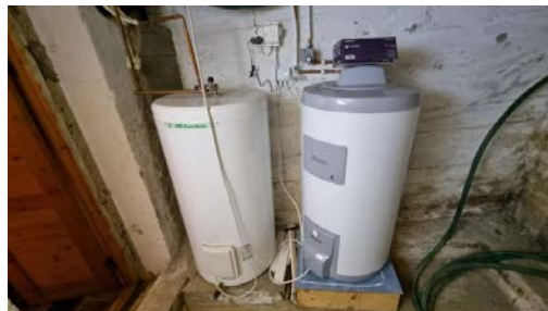
Varmtvannsbereidere til sokkeletasjen og hoveddelen av boligen.
