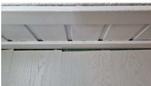
Ikke tilfredsstillende avslutning av gulv.
