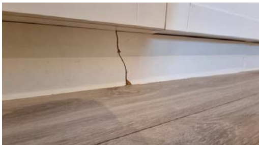
Sprekk i sokkel.
