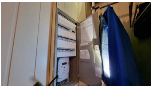
El-skap plassert i entré/trappegang i hoveddel.
