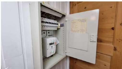
El-skap i sokkeletrasje.
