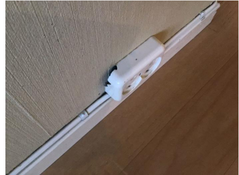
skade på el-stikk stue
