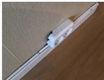
skade på el-stikk stue
