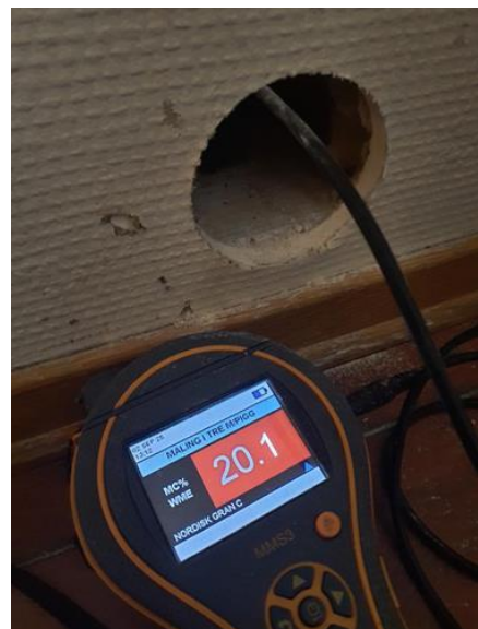
Våtrom - [Fuktmåling med pigg i vegg mot dusjsone bad 204 B, utført fra soverom.]
