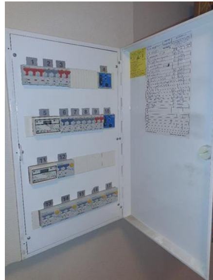
Elektrisk anlegg - [Sikringskap ]
