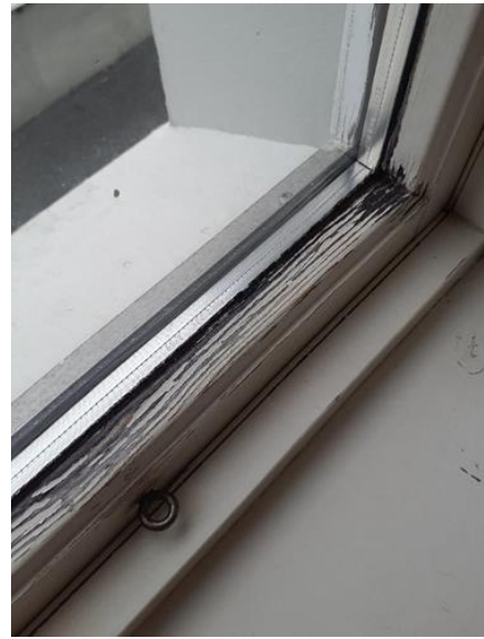
Vinduer - [Malingslitasje som følge av kondensering innside vindu.]
