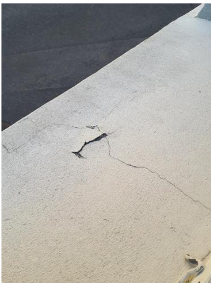
Fasader inkl. kledning - [Riss/sprekk og mindre avskalling fasade, bilde tatt ved vindu til soverom (største) 204.]
