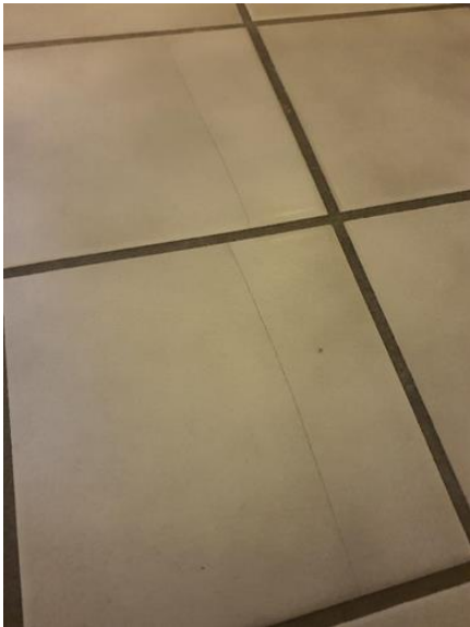
Våtrom - [Riss/sprekker i gulvfliser bad 204.]
