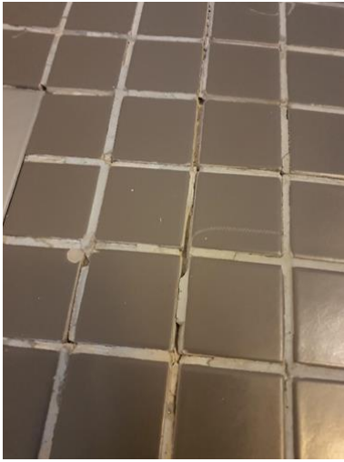
Overflater gulv - [Sprekker i gulv bad 204 B.]
