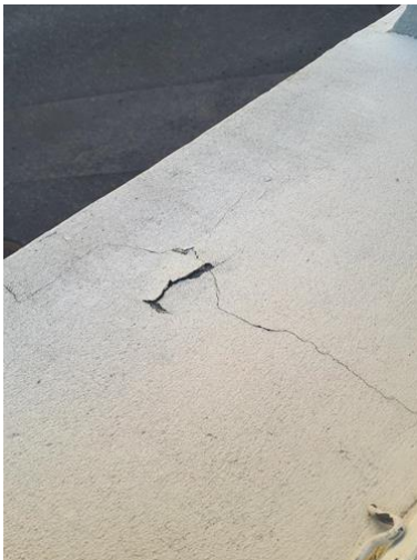
Fasader ink. kledning - [Riss/sprekk og mindre avskalling fasade, bilde tatt ved vindu til soverom (største) 204.]
