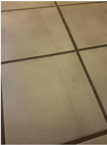
Våtrom - [Riss/sprekker i gulvfliser bad 204.]
