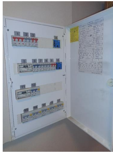
Elektrisk anlegg - [Sikringskap ]
