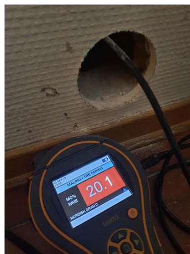
Våtrom - [Fuktmåling med pigge i vegg mot dusjsone bad 204 B, utført fra soverom.]
