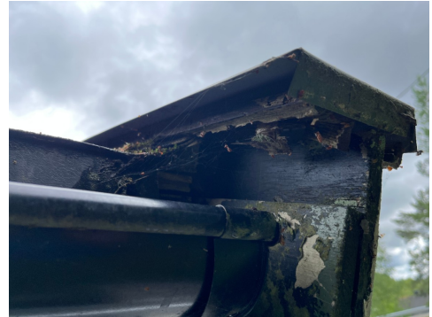
Dekkbord under vindskibeslag har råteskader.
