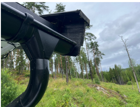
Ende på vindskier har råteskader.
