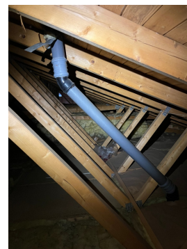
Avløpsrør for lufting bør isoleres på loft.
