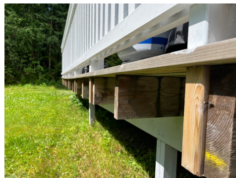
Terrassen har skjevheter.
