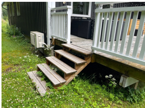
Trapp mangler rekkverk.
