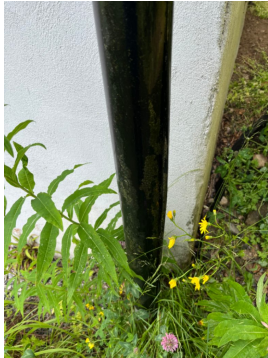
Nedløpsrør med frostsprenging.
