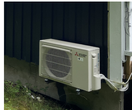
Kondensvann fra varmepumpe må ledes vekk fra grunnmur.
