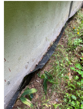
Grunnmursplast mangler tetningslist.
