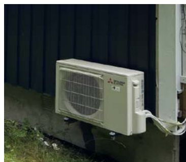
Kondensvann fra varmepumpe må ledes vekk fra grunnmur.
