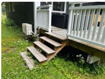
Trapp mangler rekkverk.
