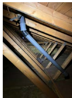
Avløpsrør for lufting bør isoleres på loft.
