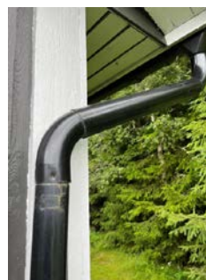
Nedløp er montert med feil, så vann renner på yttersiden av rør.
