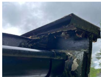
Dekkbord under vindskibeslag har råteskader.
