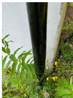
Nedløpsrør med frostsprenging.
