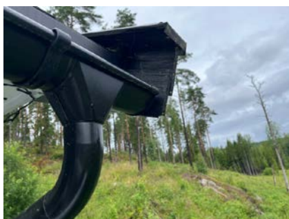
Ende på vindskier har råteskader.
