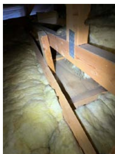
Et felt med manglende isolasjon ved pipe.
