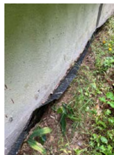
Grunnmursplast mangler tetningslist.
