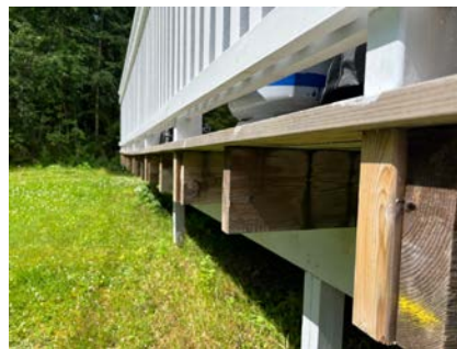
Terrassen har skjevheter.
