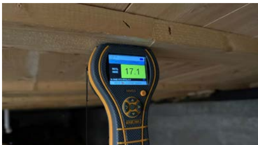
Fuktmåling i trevirke i krypekjelleren.
