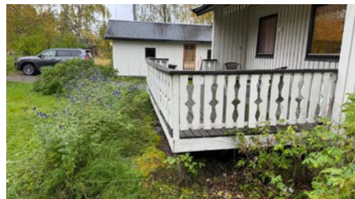
Altan ved stuen. Skjevheter
