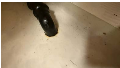
Eksempel på utett rørfjennomføring
