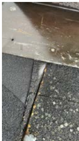
Eksempel på skade på takteking utvendig
