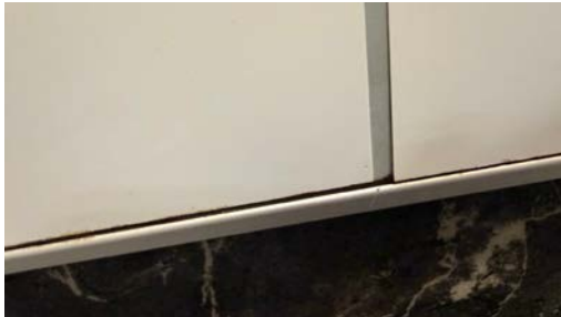
Manglende fuge i nedkant av baderomsplater
