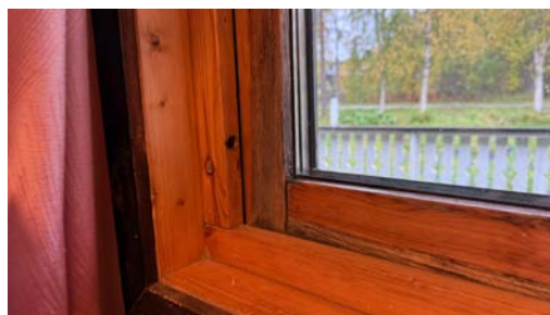
Fuktmerker i vindu
