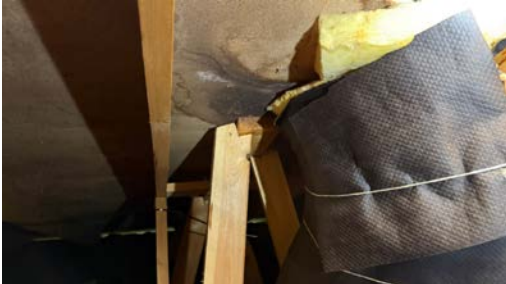
Midlertidig skadebegrensning på taktro
