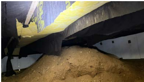
Skader på sydde matter under etasjeskillet.
