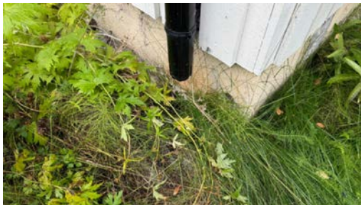
Eksempel på feil avslutning av taknedløp
