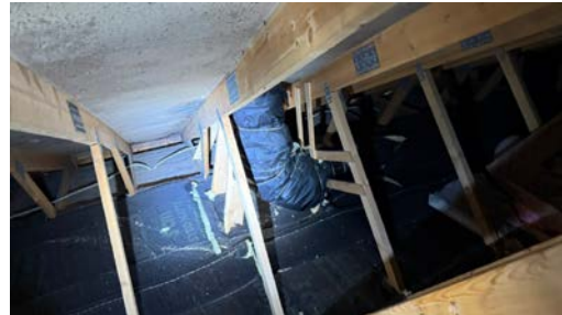
Eksempel på skade i taktro og for lang spiker
