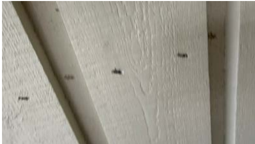
Dyp spikring av kledningen.
