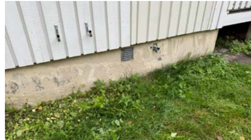
Eksempel på skader på fasader.
