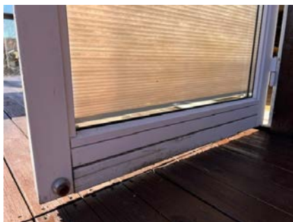
Dør med begynnende symptomer på råteskader i nedre del.
