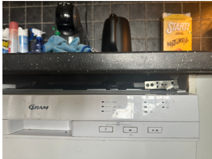
Glippe mellom benkeplate og oppvaskmaskin
