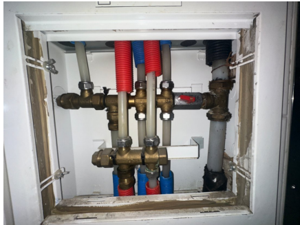
Samleskap med rørkurser og stoppekraner
