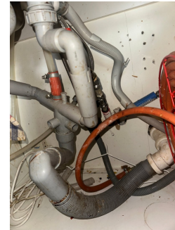
Rørpropplegg i kjøkkenbenk med Waterguard
