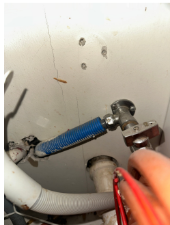
Manglende tettemuffe på vannrør på kjøkken
