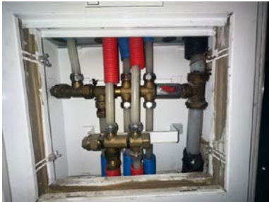
Samleskap med rørkurser og stoppekraner
