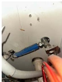
Manglende tettemuffe på vannrør på kjøkken
