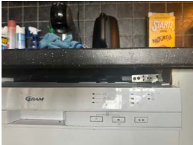
Glippe mellom benkeplate og oppvaskmaskin
