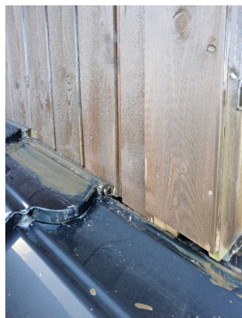
Ufagmessig og utett avslutning mellom tak-vegg
