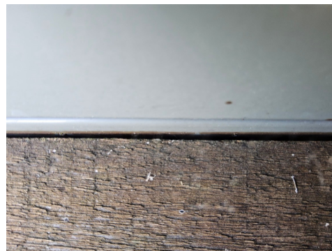
Vannbrett er montert inntil vindu og ikke i underkant. Glippe mellom vannbrett og vindu.
