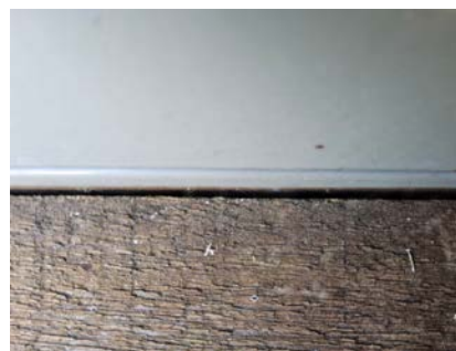
Vannbrett er montert inntil vindu og ikke i underkant. Glippe mellom vannbrett og vindu.
