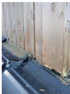
Ufagmessig og utett avslutning mellom tak-vegg
