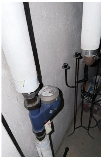
Vannmåler og hovedstoppekran plassert i kjeller.
