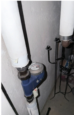
Vannmåler og hovedstoppekran plassert i kjeller.
