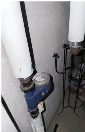
Vannmåler og hovedstoppekran plassert i kjeller.
