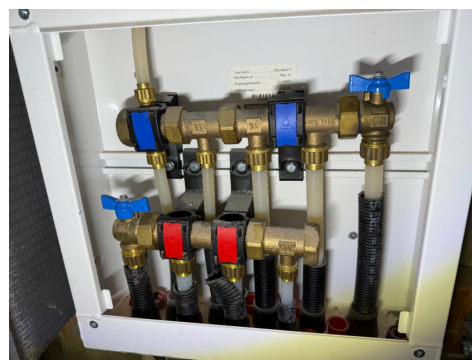
Rørskap på bad med stoppekraner
