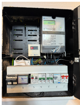
Elskap, plassert i felles trappegang.
