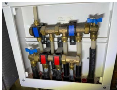
Rørskap på bad med stoppekraner
