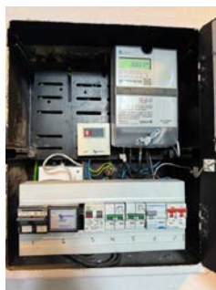
Elskap, plassert i felles trappegang.
