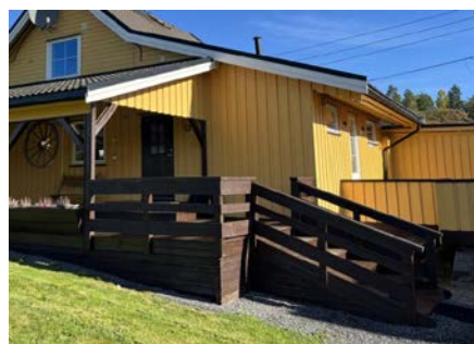
Store åpninger i rekkverk
