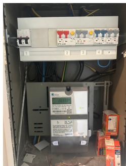
Sikringsskap plassert i felles oppgang.
