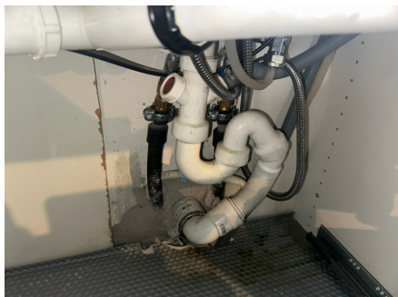
Røropplegg i kjøkkenbenk
