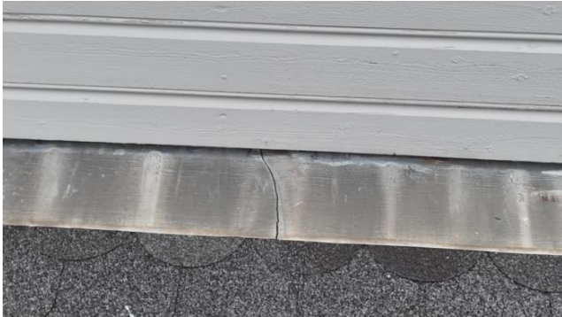
Sprekk i blytekkning.
