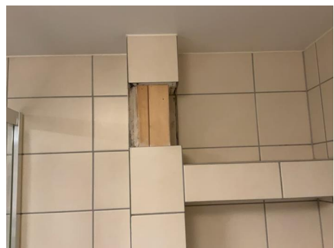
Manglende fliser på søyle.
