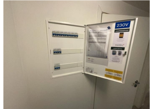
Sikringsskap i kjeller.
