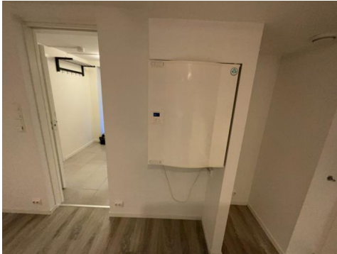
Ventilasjonsanlegg i kjeller.
