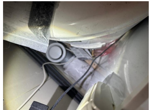
Overtrykksventilen på bereder i 1. etasje.
