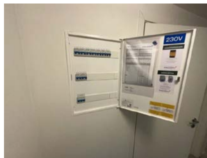
Sikringsskap i kjeller.
