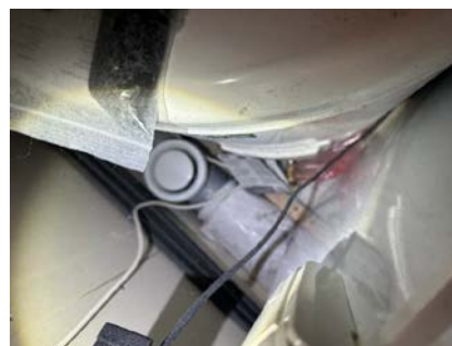
Overtrykksventilen på bereder i 1. etasje.
