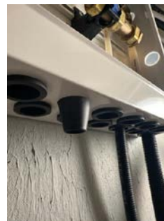
Rørskap i 1. etasje uten drenering tilkople avløp.
