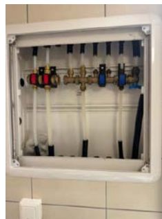
Rørskap i kjeller der nytt rør for vanninntak ligger i høyre side.
