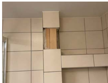
Manglende fliser på søyle.
