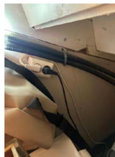
Tilkoplingen til berederen i kott i 1. etasje.
