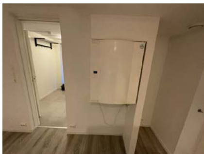
Ventilasjonsanlegg i kjeller.
