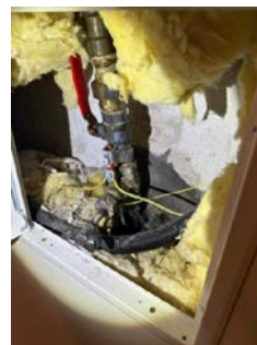
Stoppekran og vanninntak er i vegg på soverom i kjeller. Stoppekranen er for hele huset, det er ikke egen stoppekran for 1. etasje.
