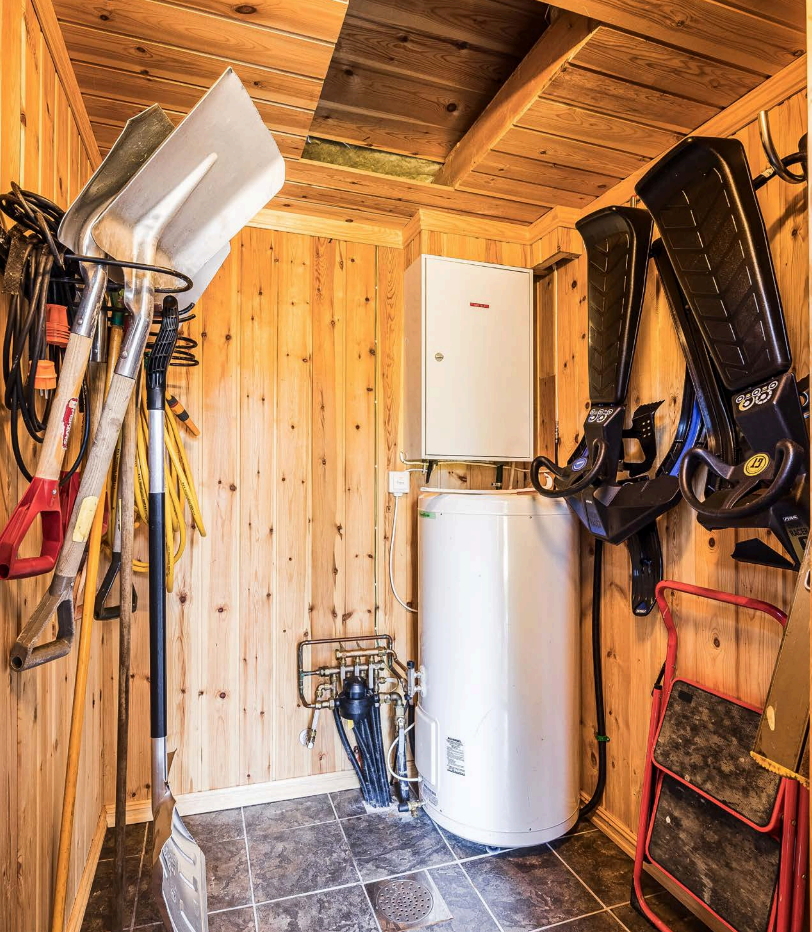
Utvendig bod/teknisk rom ved inngangspartiet. Rommet er utstyrt med varmtvannsbereider og sikringskap med automatsikringer.
