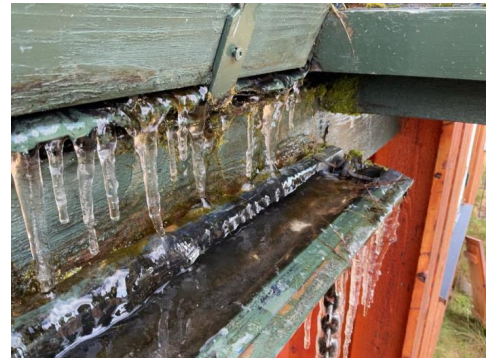
Slitasje i forkantbord, manglende forkantbeslag
