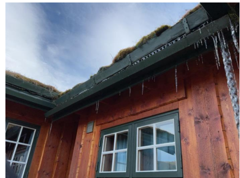
Lekkasje fra renne
