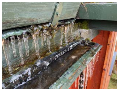
Slitasje i forkantbord, manglende forkantbeslag
