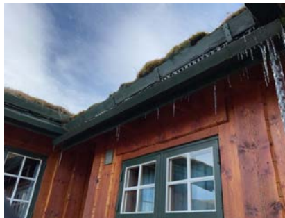
Lekkasje fra renne
