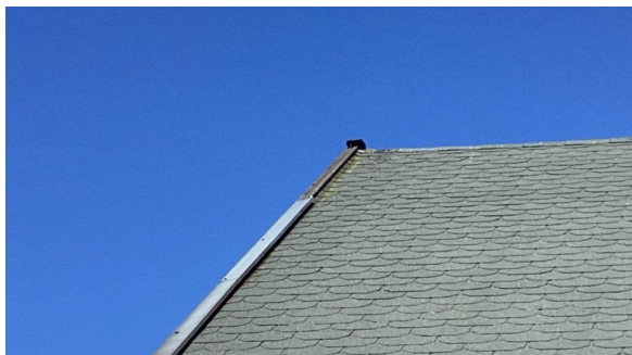
Det mangler isbordbeslag på ett sted.
