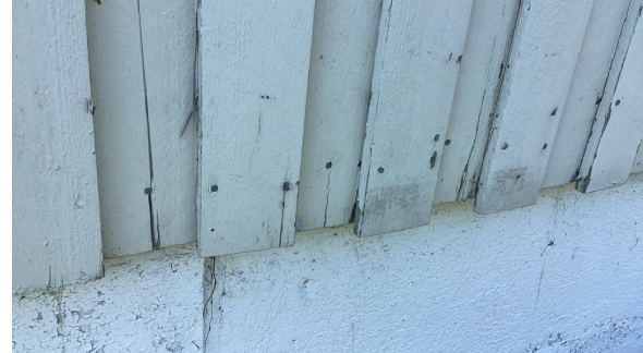
Eksempel på sprekker i kledningsbord.
