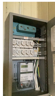
Sikringsskap i trappegang til 2. etasje.
