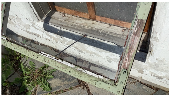
Eksempel på slitasje.
