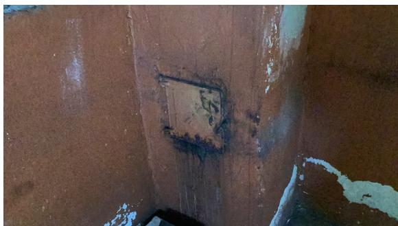
Sotluke i kjeller.
