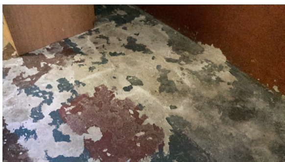
Eksempel på avskaling på gulv.
