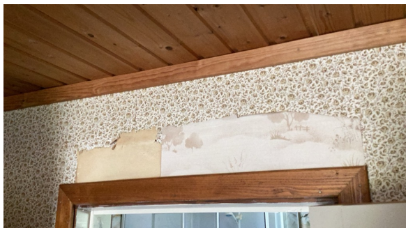
Eksempel på slitasje/avvik.
