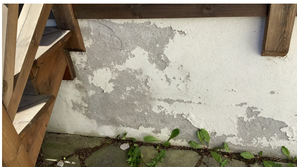
Avskaling på grunnmur.
