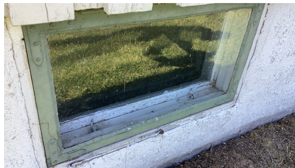
Eksempel på slitasje.
