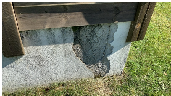
Avskaling på grunnmur.
