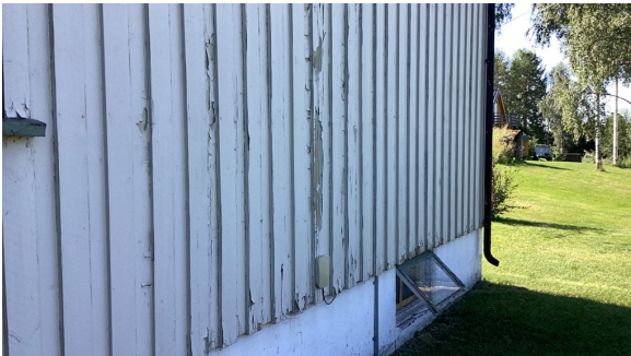
Eksempel på avskaling av maling.
