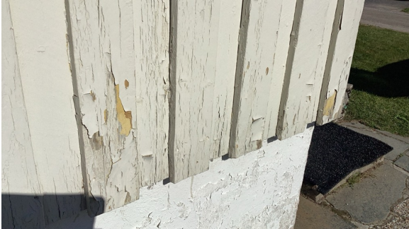
Eksempel på avskaling av maling.
