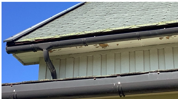
Eksempel på avskaling av maling i takutstikk.
