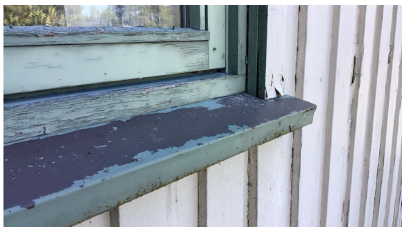
Stedvis avskaling av farge.
