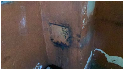
Sotluke i kjeller.
