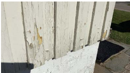
Eksempel på avskaling av maling.
