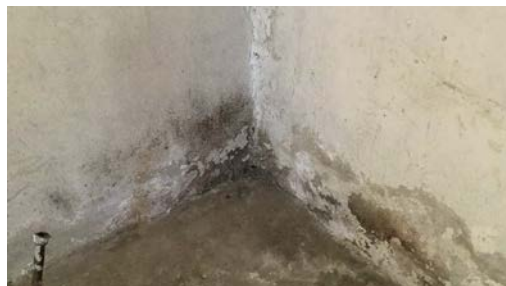
Eksempel på fuktpåkjenning.
