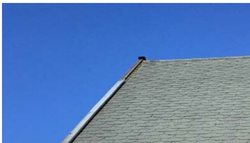
Det mangler isbordbeslag på ett sted.
