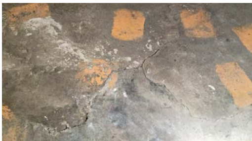
Eksempel på avskaling på vegg.
