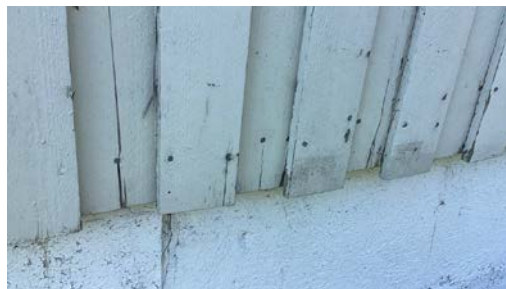
Eksempel på sprekker i kledningsbord.
