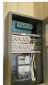
Sikringsskap i trappegang til 2. etasje.
