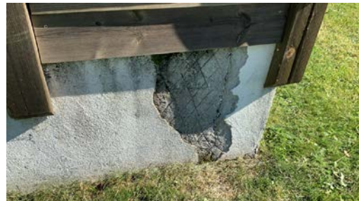
Avskaling på grunnmur.
