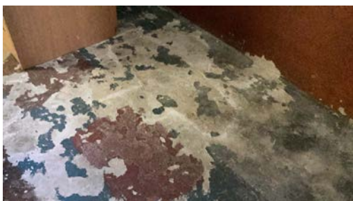
Eksempel på avskaling på gulv.
