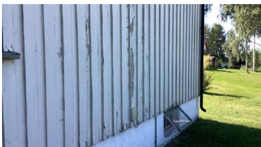
Eksempel på avskaling av maling.
