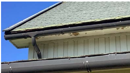
Eksempel på avskaling av maling i takutstikk.
