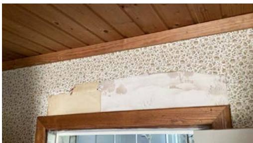
Eksempel på slitasje/avvik.
