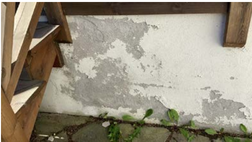
Avskaling på grunnmur.
