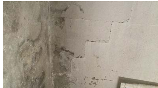
Eksempel på innvendige sprekker.
