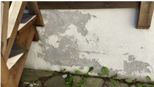
Avskaling på grunnmur.
