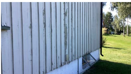
Eksempel på avskaling av maling.
