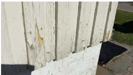
Eksempel på avskaling av maling.
