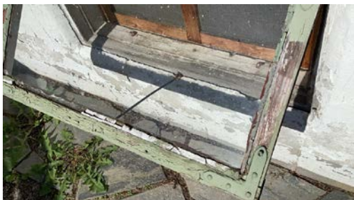
Eksempel på slitasje.
