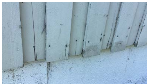
Eksempel på sprekker i kledningsbord.
