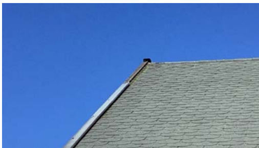
Det mangler isbordbeslag på ett sted.
