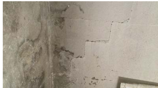
Eksempel på innvendige sprekker.
