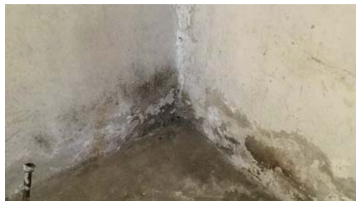
Eksempel på fuktpåkjenning.
