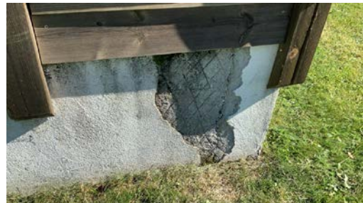
Avskaling på grunnmur.
