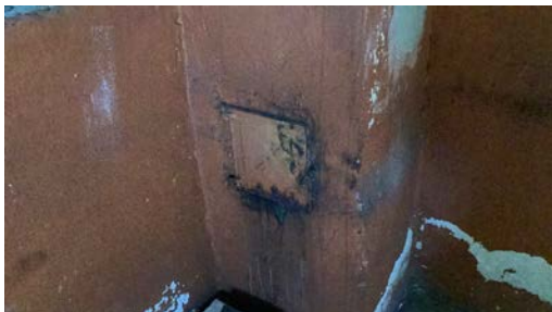
Sotluke i kjeller.
