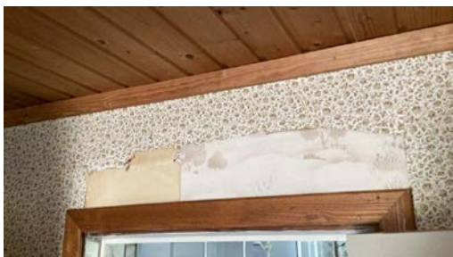
Eksempel på slitasje/avvik.
