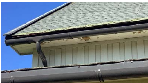
Eksempel på avskaling av maling i takutstikk.
