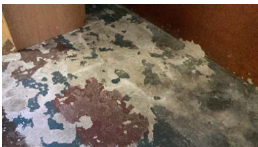
Eksempel på avskaling på gulv.
