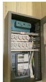
Sikringsskap i trappegang til 2. etasje.
