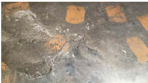
Eksempel på avskaling på vegg.
