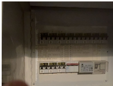
Sikringsskap i garderobeskap i entré.
