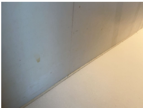
Noe slitt fuger mellom benkepkater og vegg.
