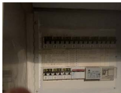
Sikringsskap i garderobeskap i entré.
