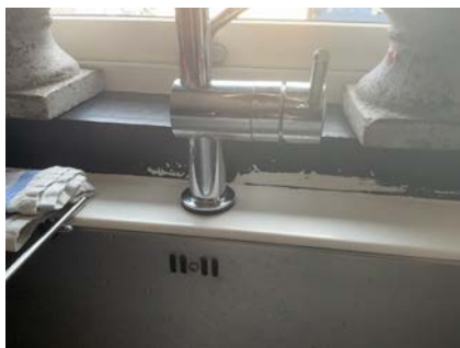
Slitt på vegg ved vask.
