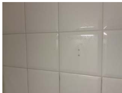
Stedvis noe hull på vegger etter tidligere oppheng.
