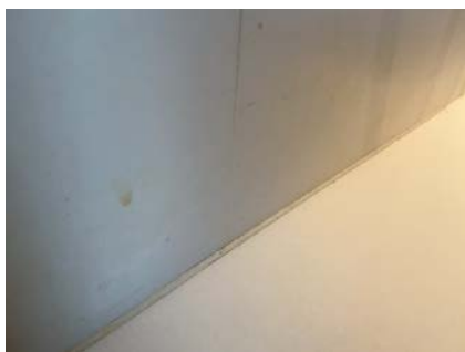
Noe slitt fuger mellom benkepkater og vegg.
