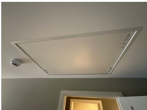
Ventilasjonsaggregat i taket i entreen
