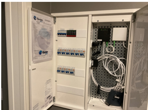
Sikringsskap i boden
