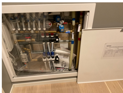
Rød i rør skap for tappevann og gulvvarme
