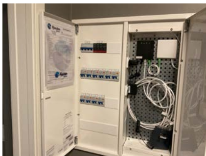
Sikringsskap i boden
