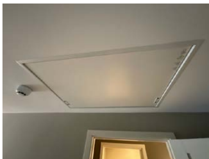
Ventilasjonsaggregat i taket i entreen
