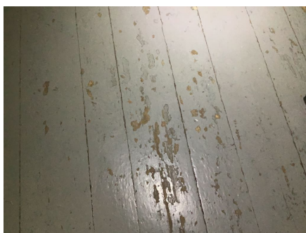
Bildet viser eksempel på slitasje på gulv.
