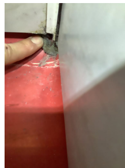
Bildet viser utett hjørne i vinylbelegget.
