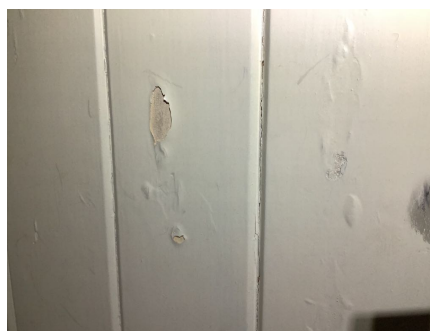
Bildet viser løs maling.
