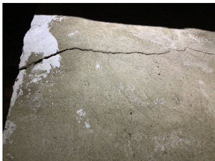
Bildet viser eksempel på sprekk i pipe.
