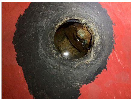
Bildet viser støpejernsluk og at det kan se ut til å være påført tettemasse rundt sluket.
