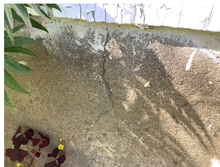
Bildet viser eksempel på utvendig skråriss.
