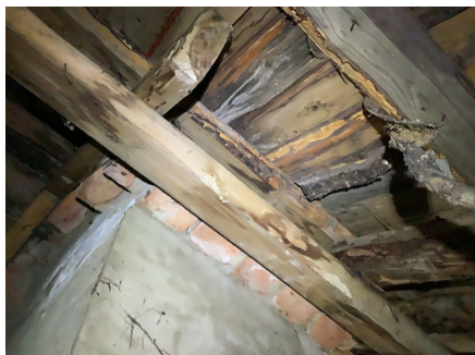
Bildet viser eksempel på fuktskjolder rundt pipe.
