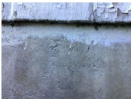
Bildet viser at det ikke er lufting bak bordkledningen.
