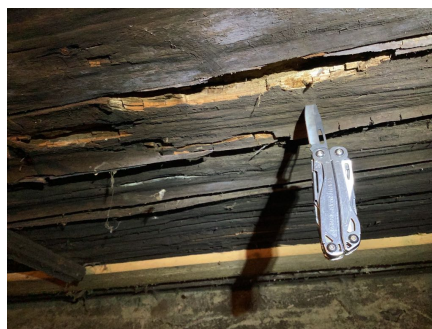
Bildet viser råteskadet himling.
