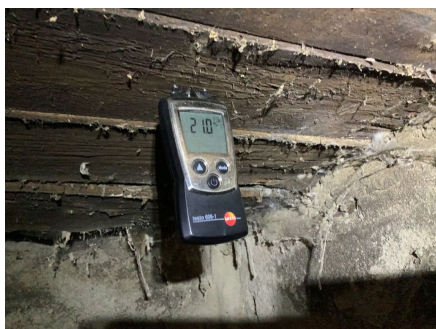
Bildet viser at det måles skadelig fuktinnhold i himling.
