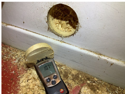
Bildet viser fuktmåling på baksiden av panel, og at vegg er isolert med flis.
