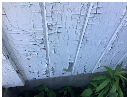
Bildet viser at maling sprekker opp og løsner.
