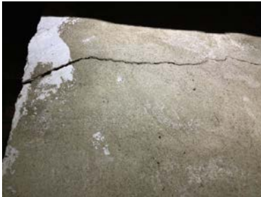
Bildet viser eksempel på sprekk i pipe.
