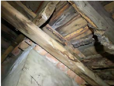
Bildet viser eksempel på fuktskjolder rundt pipe.
