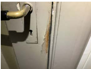
Bildet viser eksempel på slitasje.
