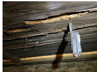
Bildet viser råteskadet himling.
