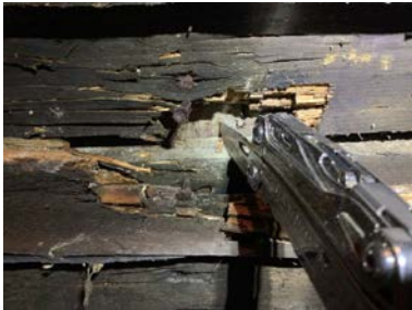
Bildet viser råteskadet kellerhimling, og stikktaking i frisk gulvbjelke.
