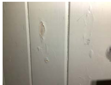
Bildet viser løs maling.
