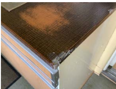
Bildet viser løs kantlist på benkeplate.
