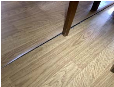
Bildet viser løst gulvbelegg.
