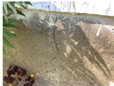
Bildet viser eksempel på utvendig skråriss.
