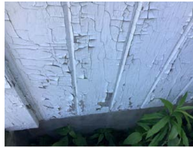
Bildet viser at maling sprekker opp og løsner.
