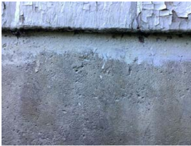
Bildet viser at det ikke er lufting bak bordkledningen.
