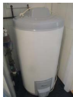
Bereder er plassert på bad/vaskerom.
