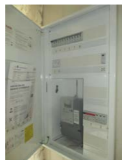
Sikringsskapet er plassert på ene soverommet.
