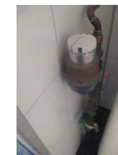
Innvendig stoppekran med vannmåler.
