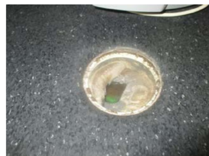
Sluk ved bereder.
