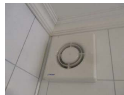
Vifte i veggen.
