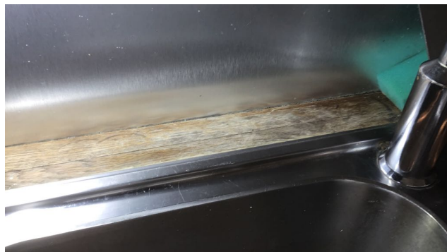
Fukt merker i benkeplate ved vask
