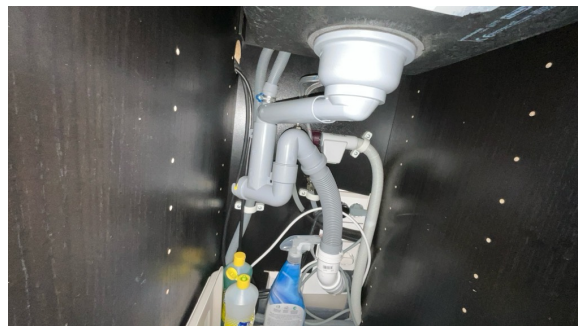
Del av rør til avløp.
