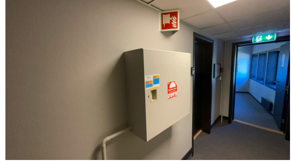
Husbrannslange med vann.
