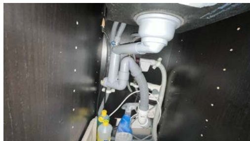
Del av rør til avløp.
