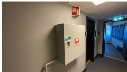
Husbrannslange med vann.
