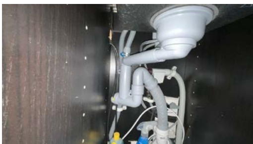
Del av rør til vann.
