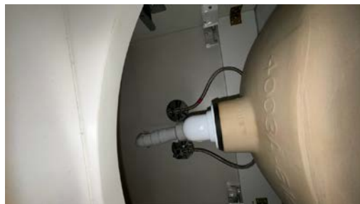
Del av rør til vann.
