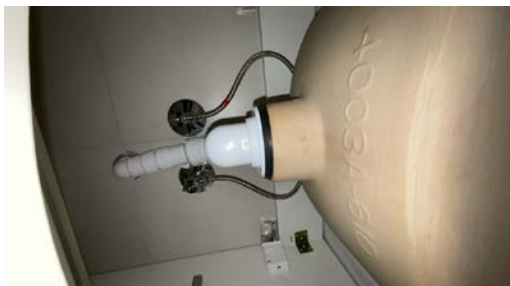
Del av rør til avløp.
