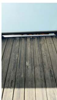
Det er værslitt/oppsprukket trevirke/trepaneler.
