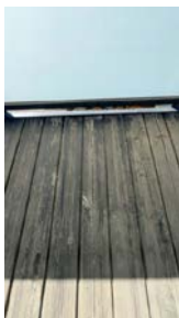
Det er værslitt/oppsprukket trevirke/trepaneler.
