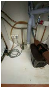
Stoppekran er plassert i kjøkkenbenk.
