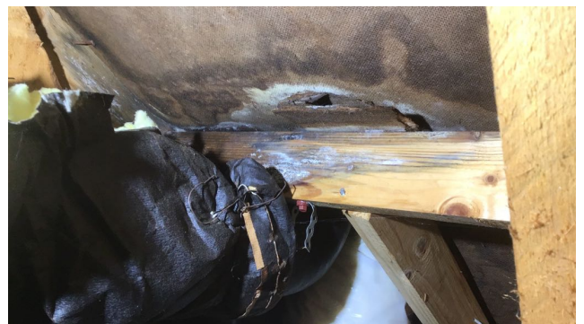
Fukt skjolder rundt gjennomføring i tak
