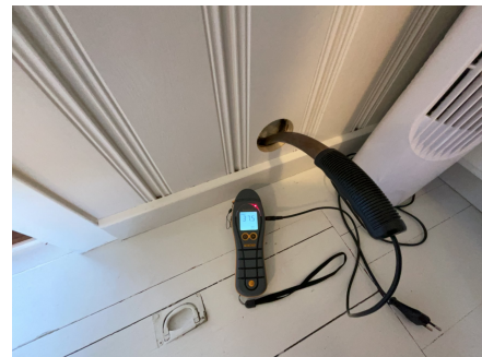
Målt fukt i bunnsvill ved hulltaking.
