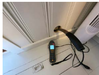
Målt fukt i bunnsvill ved hulltaking.
