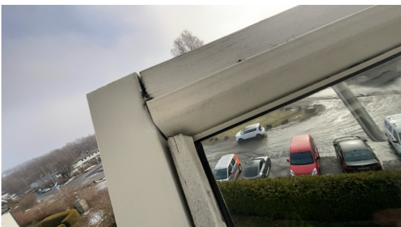
Vindu loft trapp har råteskader i lister og karm er løsnet
