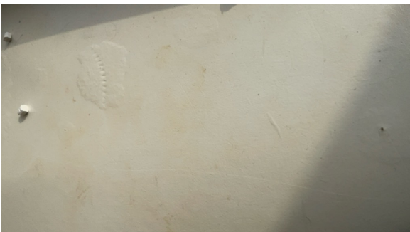
Vindu soverom loft har fuktmerker i foringer.
