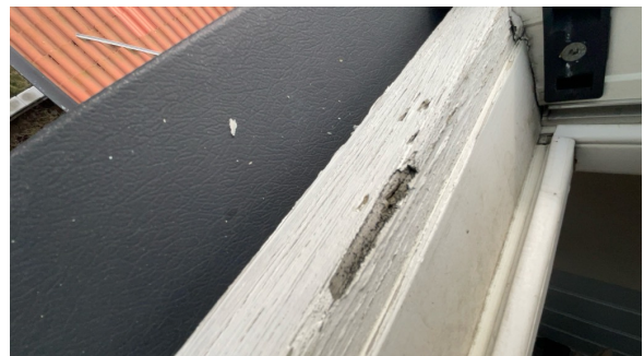
Vindu i trapp på loft har noe råteskader i karm.
