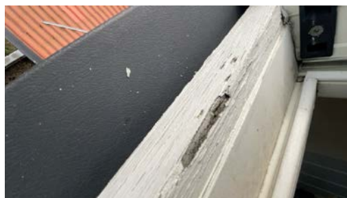
Vindu i trapp på loft har noe råteskader i karm.
