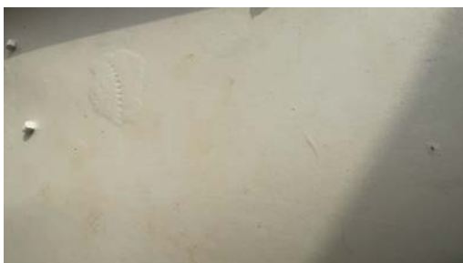
Vindu soverom loft har fuktmerker i foringer.
