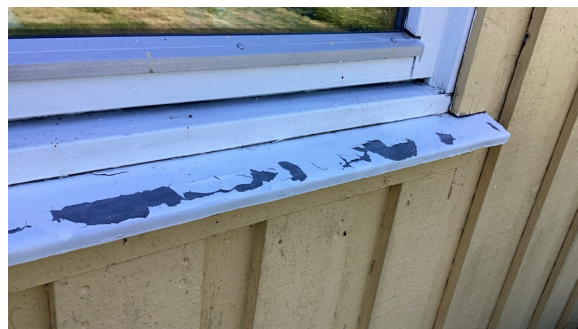
Eksempel på slitasje.
