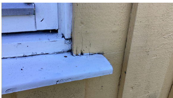
Omramminger på vinduer går ned på vannbrett.
