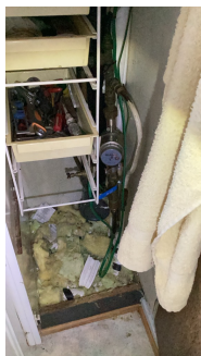
Vanninntak med måler og stoppekran.
