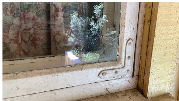
Eksempel på slitasje.
