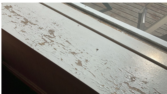
Eksempel på slitasje.
