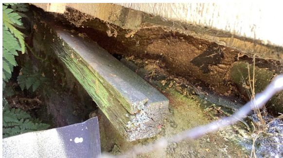
Flere steder glipper mellom grunnmur og veggkonstruksjon.
