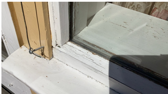
Eksempel på slitasje.
