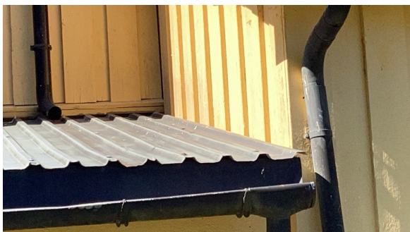
Det er ikke beslag i overgang mellom tak og vegg.
