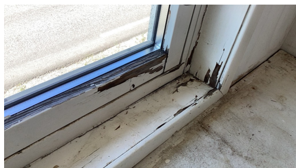
Eksempel på slitasje.
