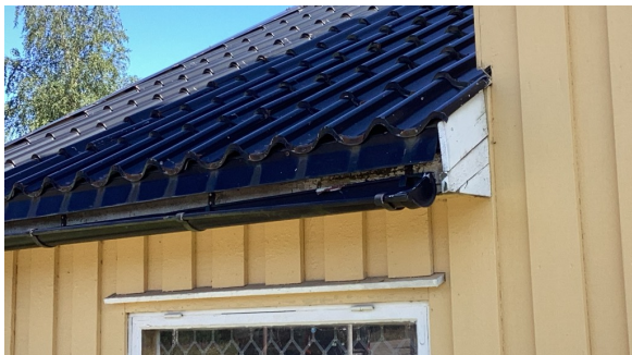
Takfotbeslag dekker ikke ned til takrenne
