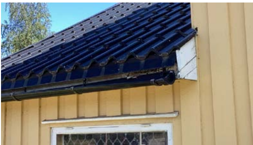
Takfotbeslag dekker ikke ned til takrenne
