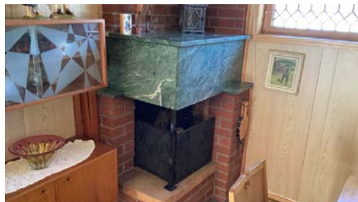
Peis uten synlig pipeløp.
