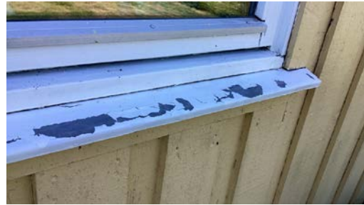
Eksempel på slitasje.
