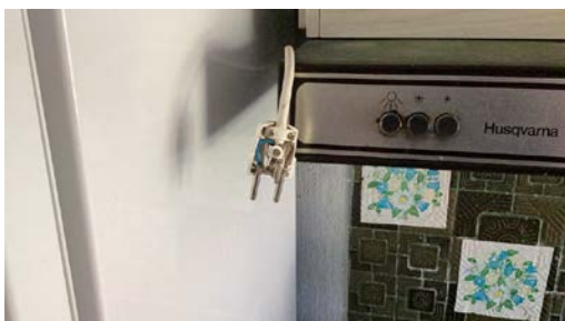
Skade på støpsel.
