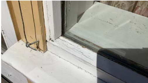
Eksempel på slitasje.
