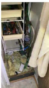
Vanninntak med måler og stoppekran.
