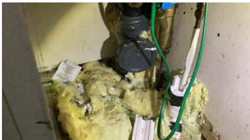
Stakepunkt i skap ved kjøkken.
