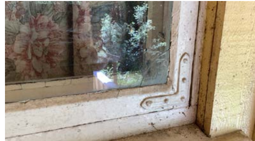
Eksempel på slitasje.
