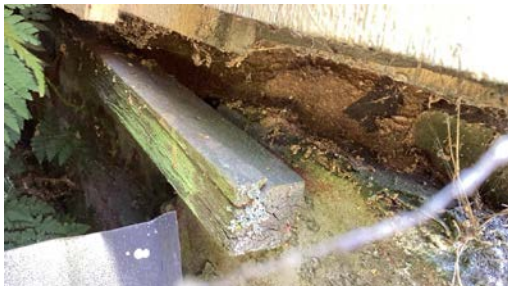
Flere steder glipper mellom grunnmur og veggkonstruksjon.
