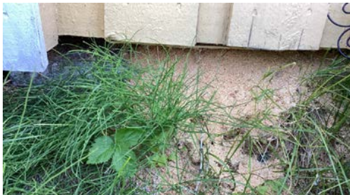
Eksempel på setning på fundament. Flis har rent ut fra vegg
