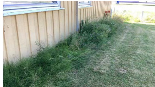
Kledning går stedvis nært ned til terreng
