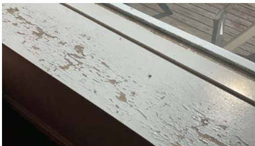
Eksempel på slitasje.
