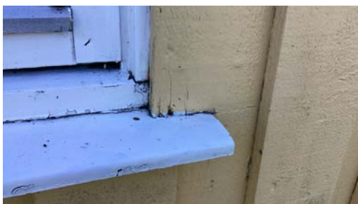
Omramminger på vinduer går ned på vannbrett.
