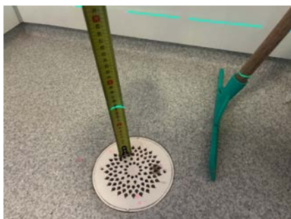
Sluk med synlig membran.
