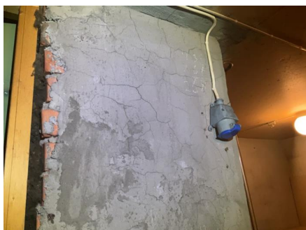
Riss i puss på pipe, synlig i kjeller.
