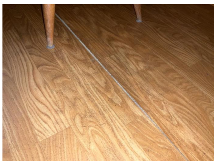
Sprekki skjøt på gulvbelegg.
