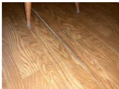
Sprekki skjøt på gulvbelegg.
