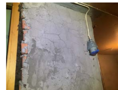
Riss i puss på pipe, synlig i kjeller.
