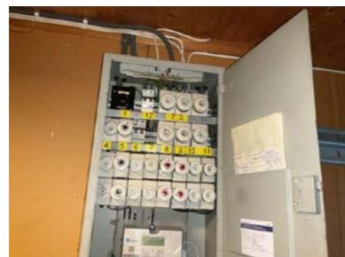
Sikringskap i garasje i boligen.
